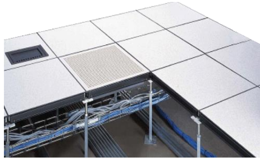
Figura 3. Canalizaciones bajo piso elevado
