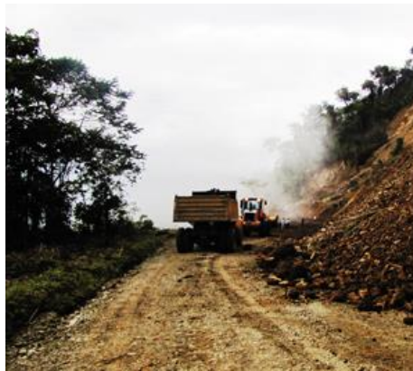
Figura 53. Estado de la Vía San Juan de Lachas- Chical Fuente: Ministerio de transporte y obras públicas.
