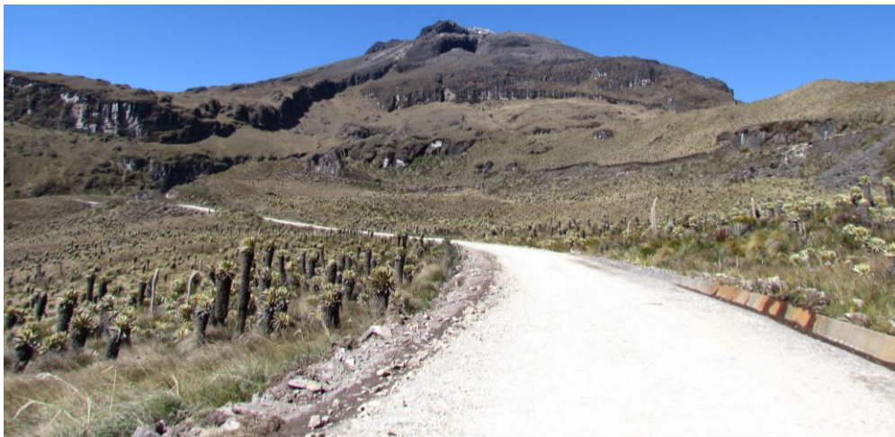
Figura 52. Estado de la vía principal Fuente: Registro personal
