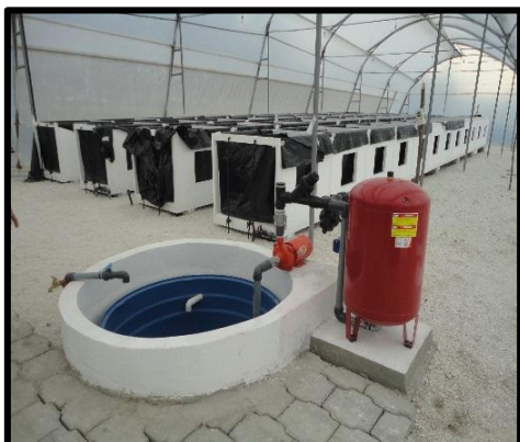
Foto N° 13 Tanque de presión
