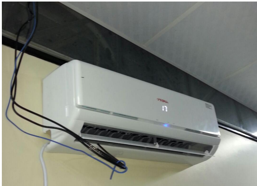
Figura 17: Aire acondicionado marca Prima. Fuente. Foto tomada por el investigador (2015).
