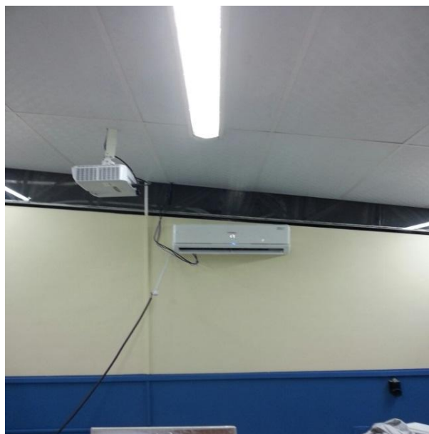
Figura 33: Sistema de aire acondicionado terminado. Fuente. Foto tomada por el investigador.
