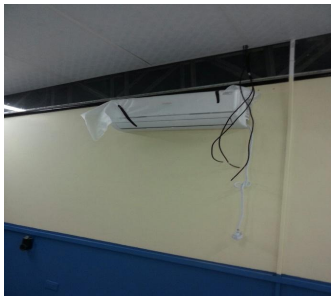
Figura 29: Unidad interior colocada. Fuente. Foto tomada por el investigador (2015).
