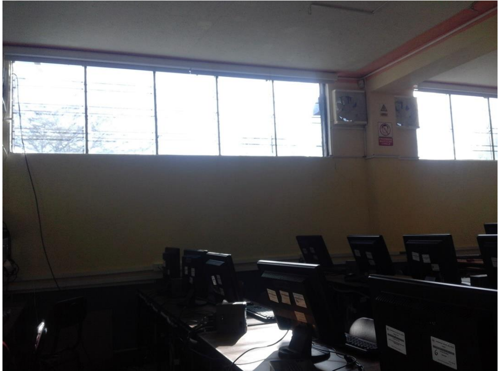
FIGURA 74: Instalación del sistema en el laboratorio 1 y pruebas del control Smart.
