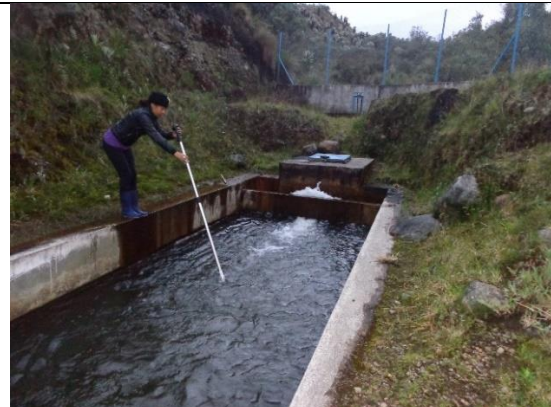
Fotografía 12. Punto de aforo 2: Estructura de captación, Sector Cucurucho
