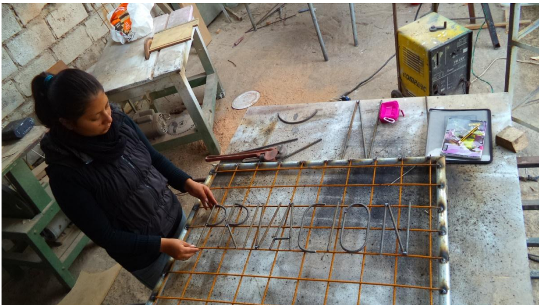
Anexo 19: Proceso de la Obra (ubicación de las palabras para proceder a soldarlas)
