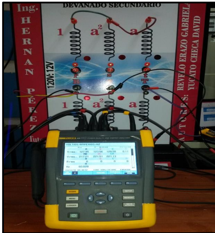
Pruebas de conexiones trifásicas
