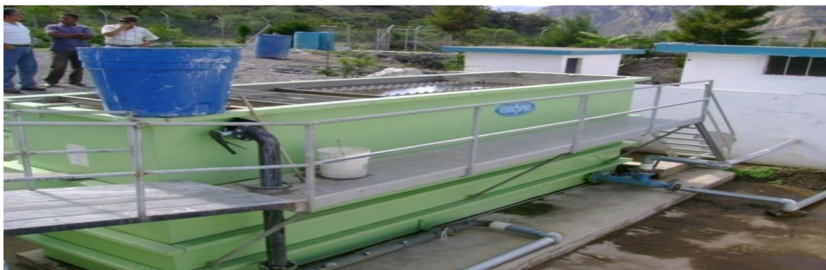
Ilustración 5: Planta de tratamiento de agua del Juncal
