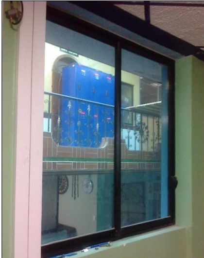
Figura 5: Ventana en el interior del Data Center de la COAC Chuchuqui Ltda.
