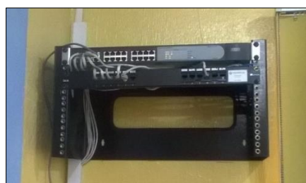
Figura 2: Equipos de conexión intermedia sin protección.
