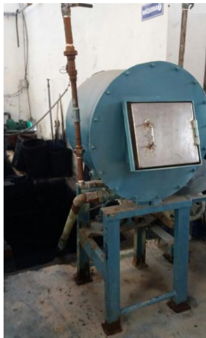
INGRESO DE AGUA
