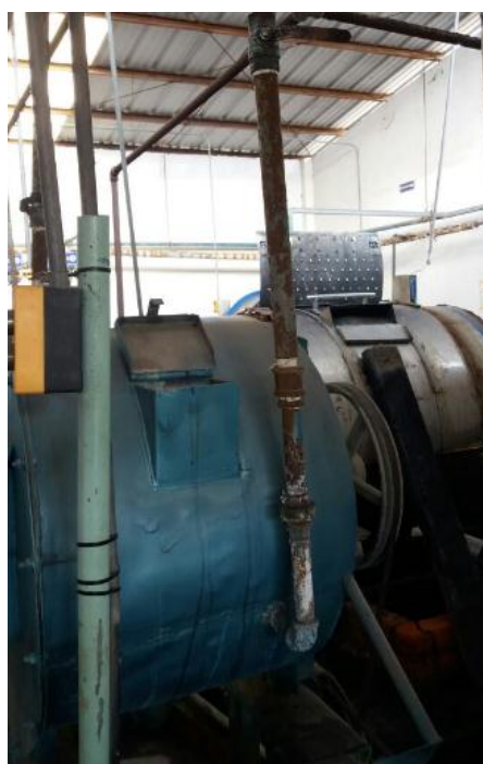
INGRESO DE VAPOR
