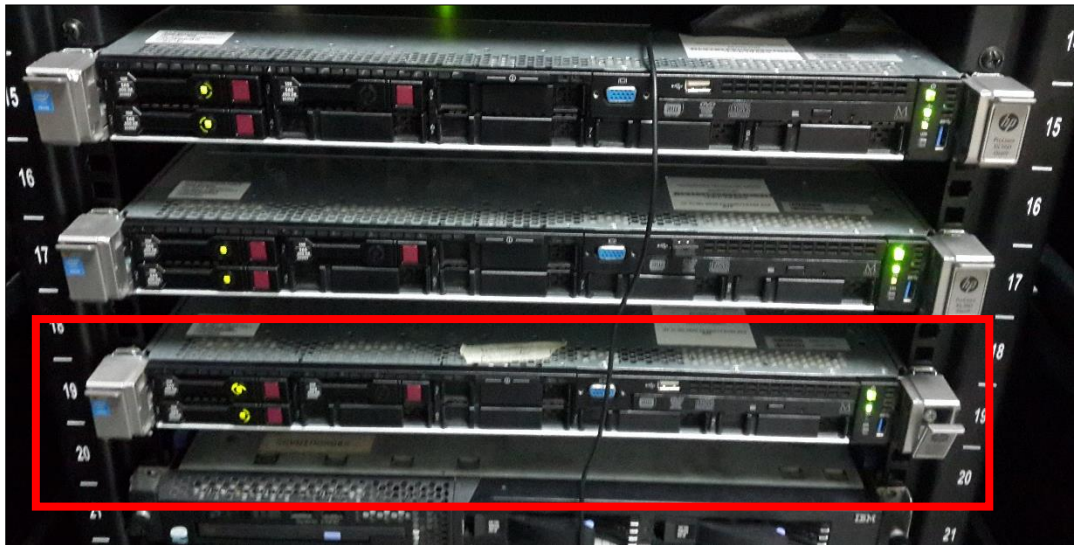
Figura 8. Servidor Hp Proliant DL 360 alojado en el Centro de datos FICA
