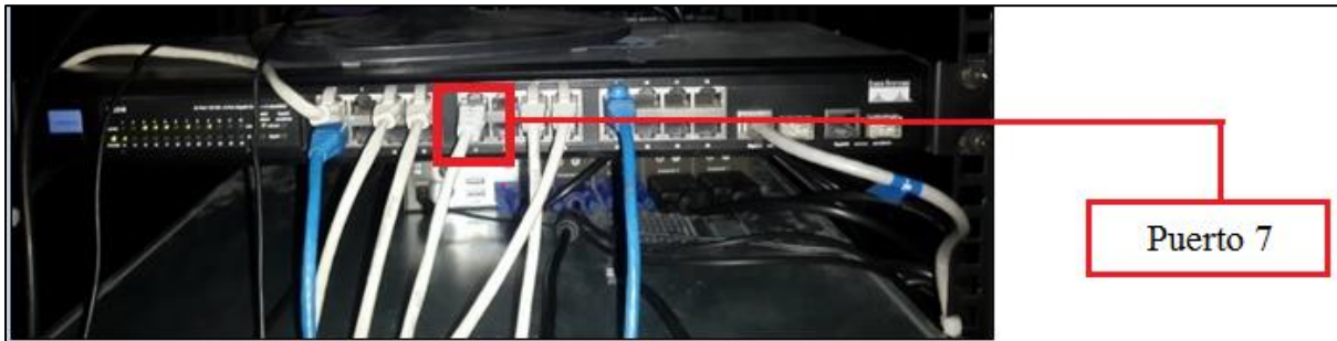
Figura 9. Switch Linksys SLM 224 Fuente: Centro de Datos FICA
