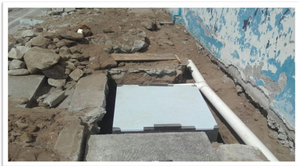
FIGURA 37: Colocación de la trampa de grasas del taller del colegio Universitario.
