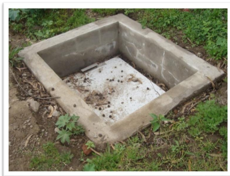
FIGURA 32: Trampa de grasas instalada en taller de la carrera de la UTN
