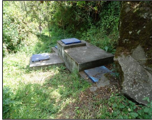
Fotografía 8. Zona de captación
