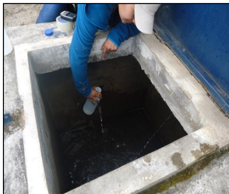
Fotografía 20. Tanque de agua Alpachaca
