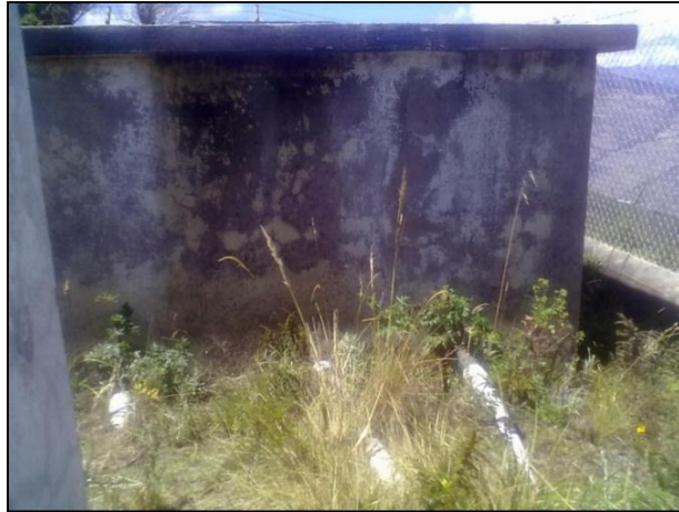
Figura 4.9. Tanque repartidor de caudales de las vertientes de La Carbonería.
