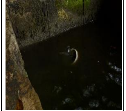
Figura 4.63 Toma de agua Alofitara en mal estado. FOTOGRAFÍA AUTOR
