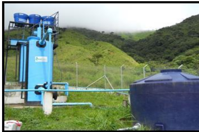
Fotografía 6. Planta de Tratamiento en La Comunidad De San Jerónimo
