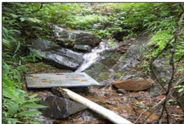
Fotografía 26. Falta de protección en la fuente y condiciones inadecuadas en el tanque de captación
