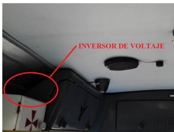
Ilustración 49 Ubicación inversor de voltaje Fuente: (Autores)
