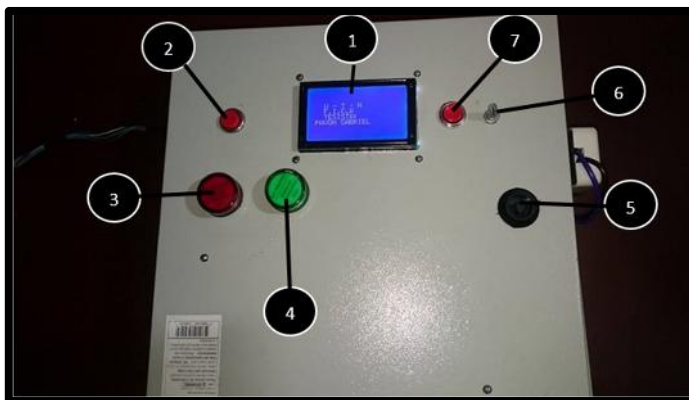
Figura 20 Parte externa del gabinete eléctrico
