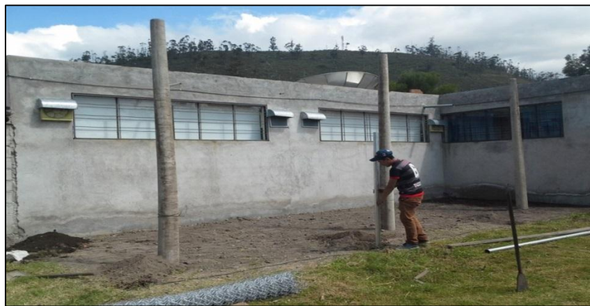
Figura 120: Cerramiento del espacio físico de la red de distribución
