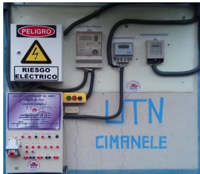
Figura 54: Tablero de Medidores
