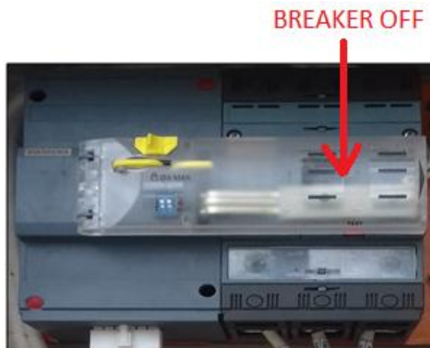
Figura 90: Breaker Motorizado en Estado OFF
