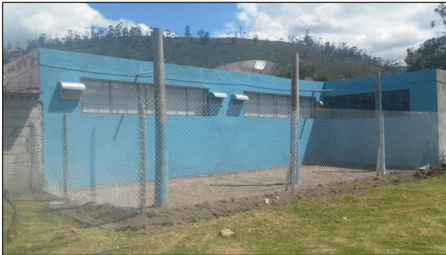
Figura 123: Vista de espacio físico terminado y adecuado para instalación de la red
