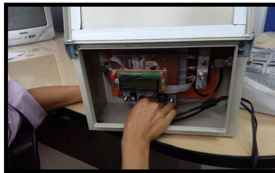
Figura 72. Conexión de la caja externa a la red eléctrica Fuente: Equipos del enlace microondas propiedad del canal universitario
