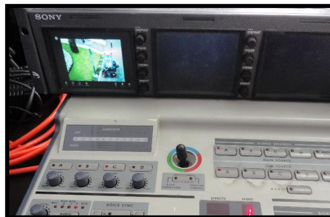
Figura 84. Fotograma enviado desde el IU hasta los monitores ubicados en las instalaciones del edificio central
