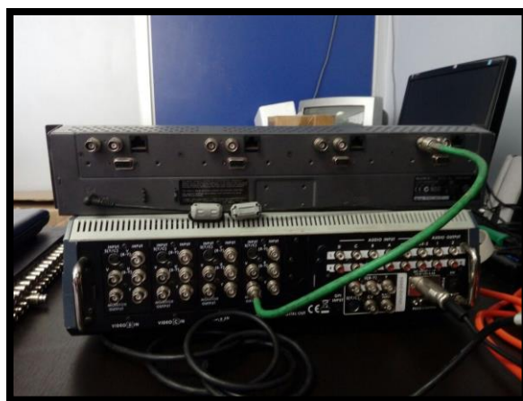
Figura 66. Conexión entre el switch de video y el monitor A
