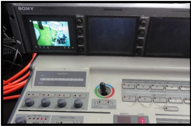
Fig. 17 Fotograma enviado desde el IU hasta los monitores ubicados en las instalaciones del edificio central
