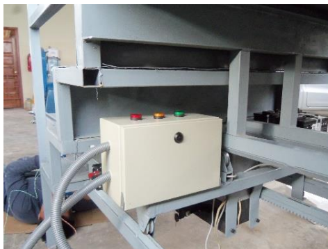
Figura 35. Caja de control
