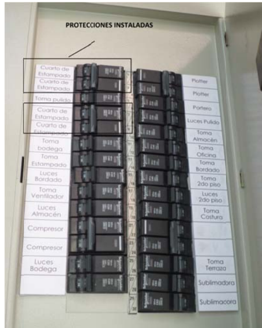
Figura 5.3. Tablero de distribución eléctrica
