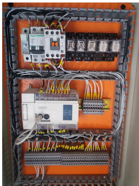
Figura 2.13. Interior del Gabinete
