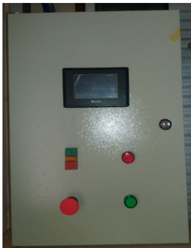
Figura 2.12. Gabinete de Control
