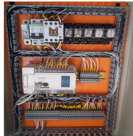
Figura 3. Interior del Gabinete
