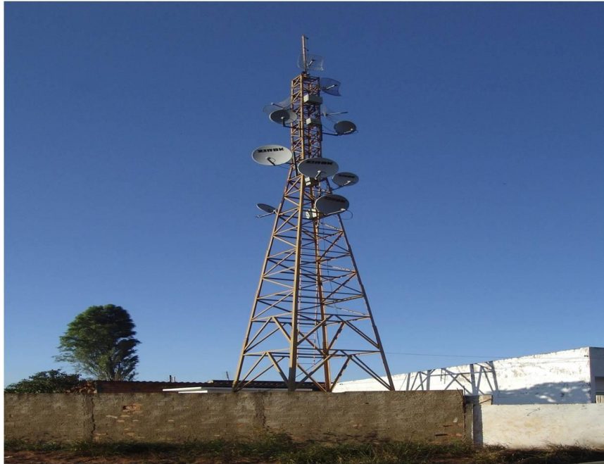
Figura 60: Torre celular autosoportada
