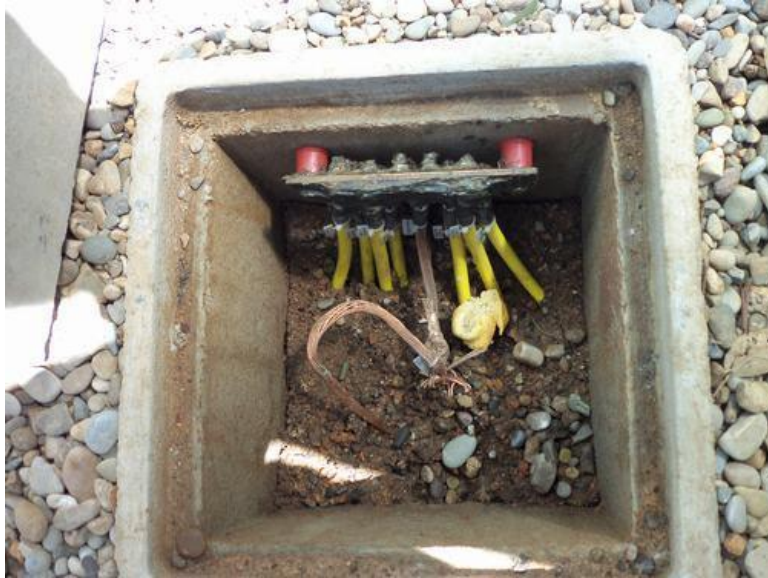
Figura 57: Pozo a tierra
