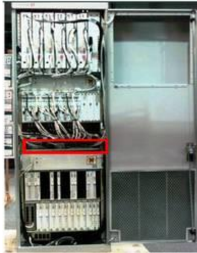
Figura 58: Equipos de radio base
