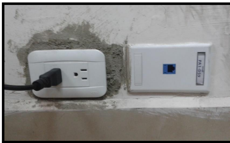
Imagen 50.-Instalación puntos de red Referencia: Dirección de Tecnologías de la Información del GAD Provincial de Imbabura, 2015.
