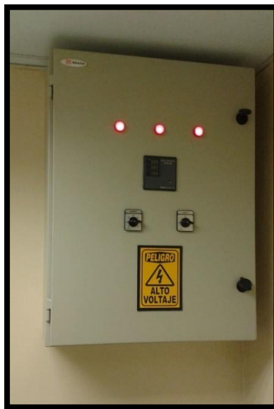
Imagen 20.- Sistema de UPS distribuido para protección de las cargas críticas. Referencia: Datacenter del GAD Provincial de Imbabura, 2015.
