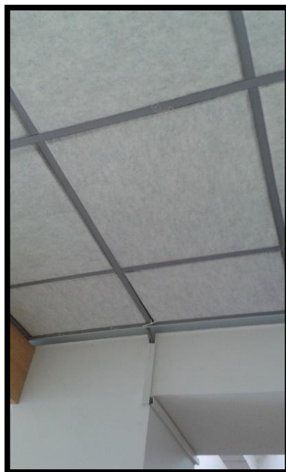
Imagen 48.-Distribución horizontal en techo falso Referencia: Dirección de Tecnologías de la Información del GAD Provincial de Imbabura, 2015.
