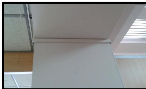
Imagen 12. Distribución horizontal en techo falso
