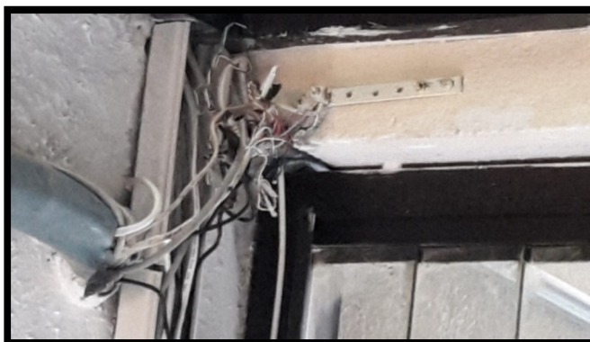
Figura 13. Cableado estructurado en el departamento de agua potable
