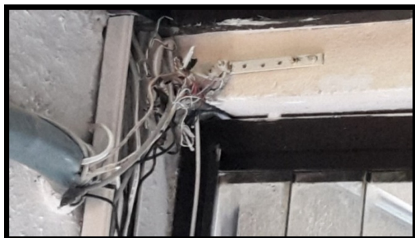
Figura 6. Cableado estructurado en el departamento de agua potable
