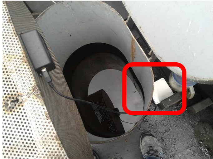
Figura 63. Instalación del sistema electrónico de monitoreo Fuente: Fotografía tomada en Ferrocarriles del Ecuador - Ibarra
