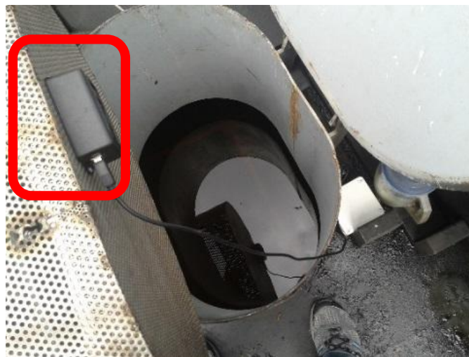
Figura g. Instalación Modulo de Sensado
