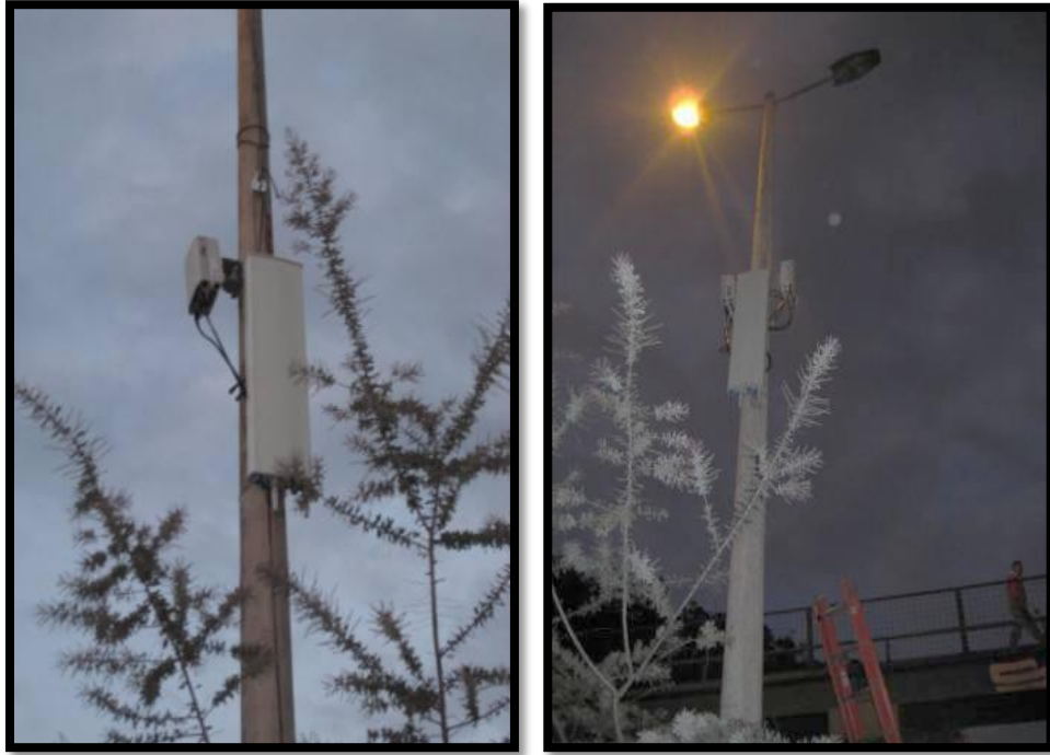
Figura 66 Vista frontal y lateral de la Antena Panel Dual Modelo ADU461819 y BTS 3902E 3G y BTS 3202 LTE Fuente: Elaborado por autor
