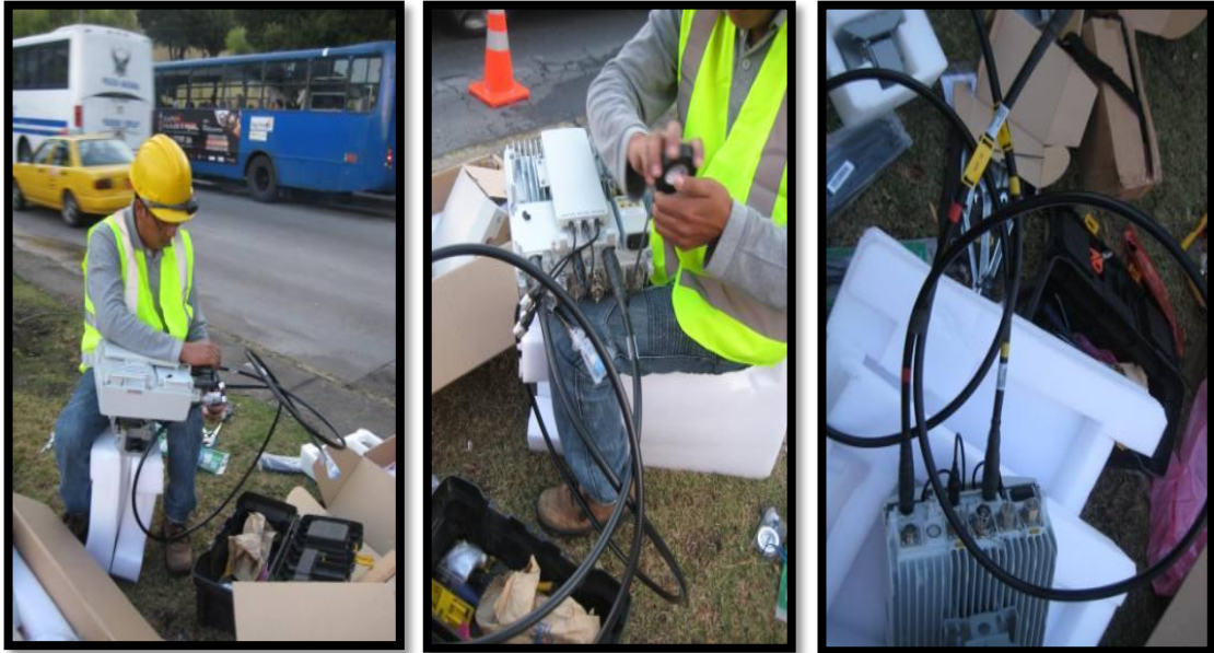
Figura 65 Instalación de BTS 3902E 3G y BTS 3202 LTE Fuente: Elaborado por autor
