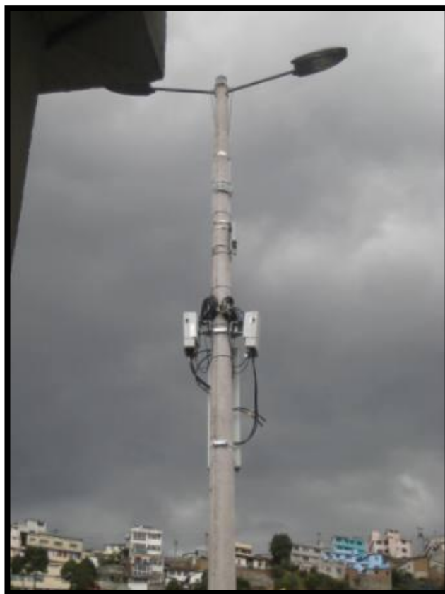
Figura 68 Vista general de solución Small Cell Instalada Fuente: Elaborado por autor
