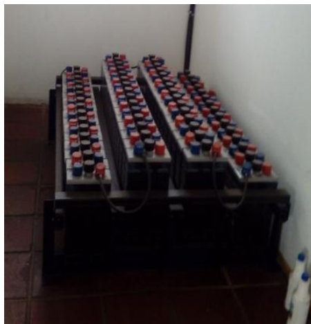
Figura 34 Banco de baterías
