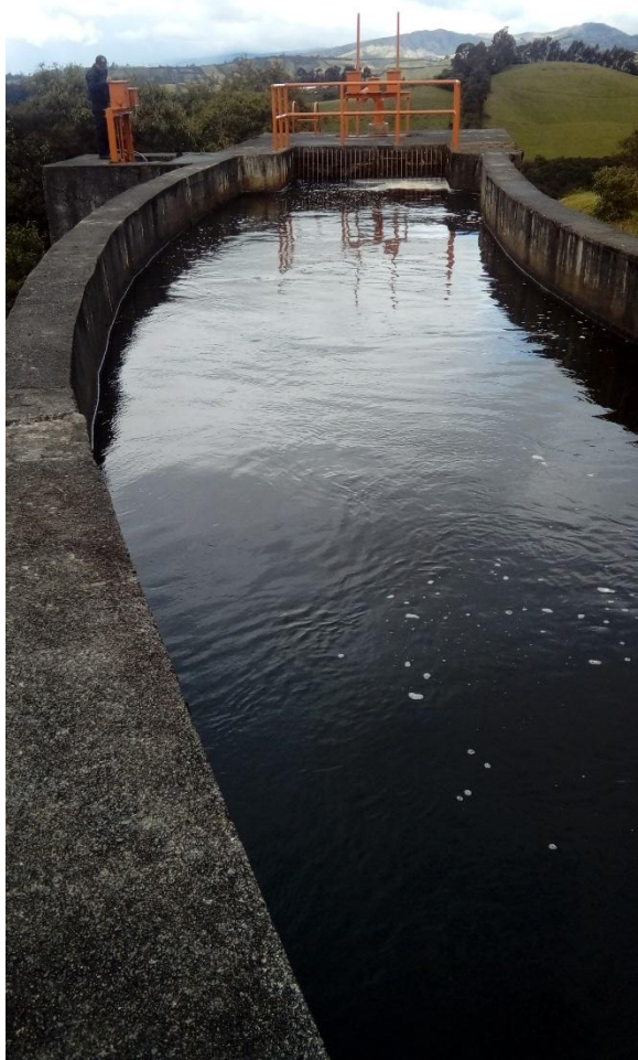
Figura 36 Vista del tanque de presión
