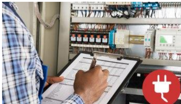
Figura 3 Verificación diaria de parámetros eléctricos
