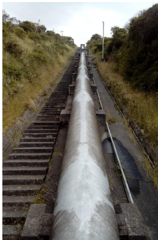
Figura 52 Tubería de presión
