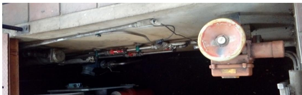
Figura 45 Sistema de refrigeración
