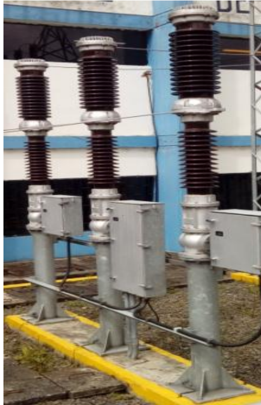
Figura 31 Disyuntor de protección del transformador
