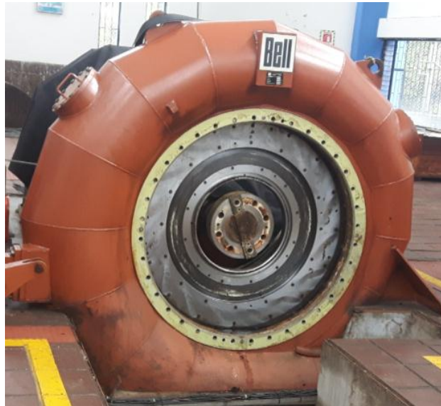
Figura 43 Vista exterior e interior de la turbina
