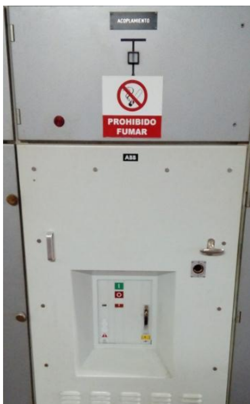
Figura 26 Disyuntor principal del generador
