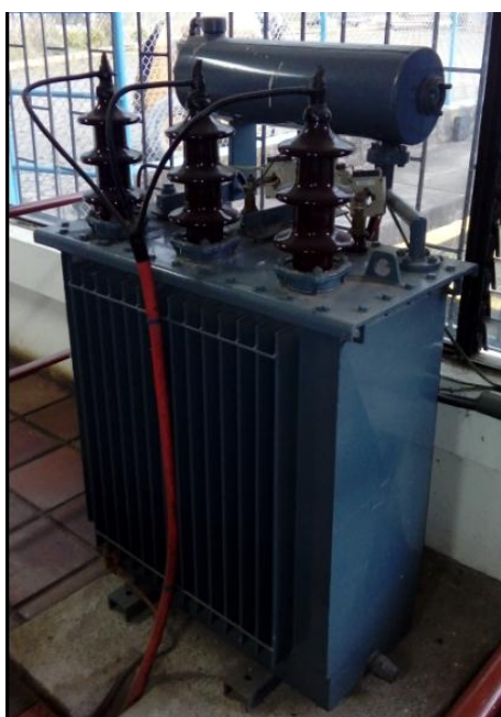
Figura 32 Transformador de servicios auxiliares
