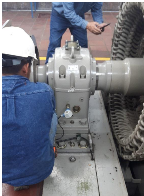
Figura 4 Inspecciones y verificaciones de temperaturas y niveles de aceite
