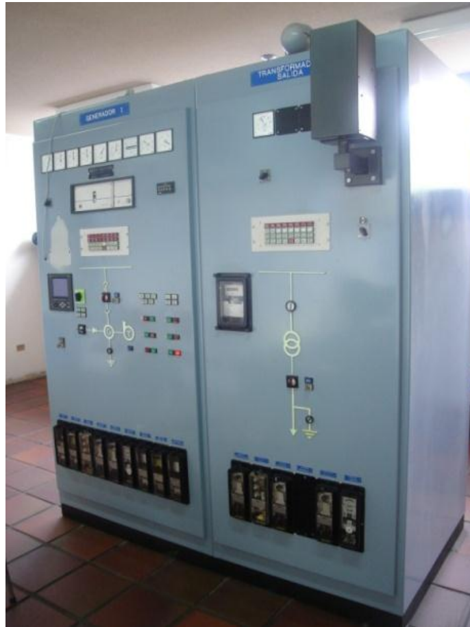
Figura 28 Tableros de control del generador y de línea principal
