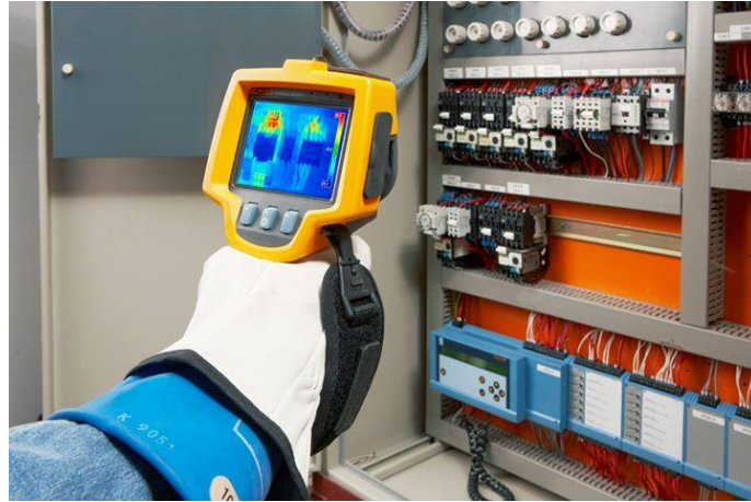
Figura 6 Pruebas de análisis de termografía
