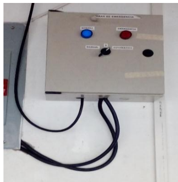
Figura 51 Tablero de control de las luminarias de emergencia
