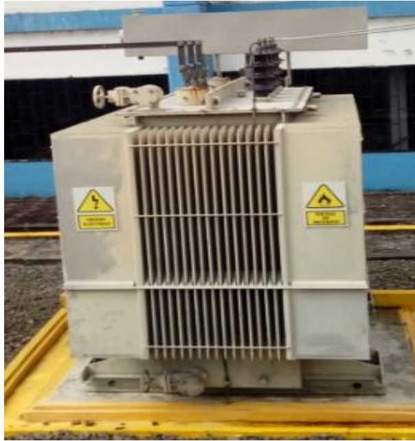
Figura 29 Transformador de potencia de la subestación
