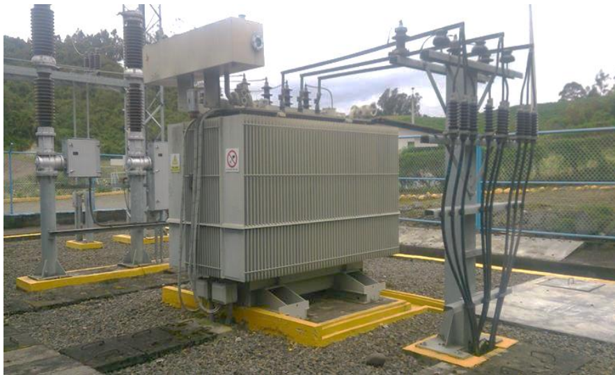
Figura 47 Transformador elevador de potencia
