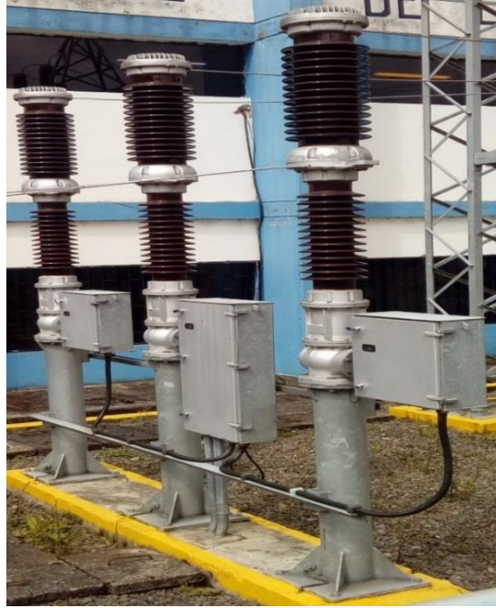
Figura 49 Disyuntor del transformador
