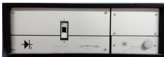
Figura 27 Regulador de voltaje
