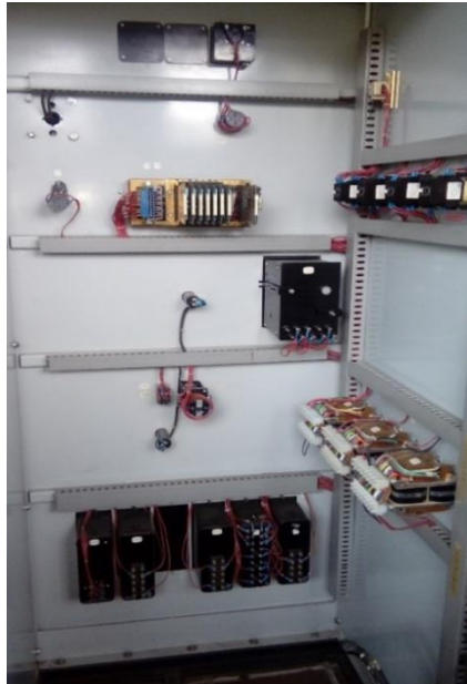
Figura 42 Vista interior del tablero de control de la línea
