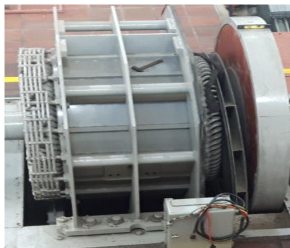
Figura 38 Vista sin carcaza del generador
