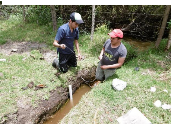
Fotografía 5. Instalación para medida de caudal (Método vertedero triangular)
