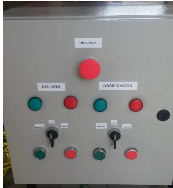
Figura 64 Tablero de control de dosificación y sellado de la máquina
