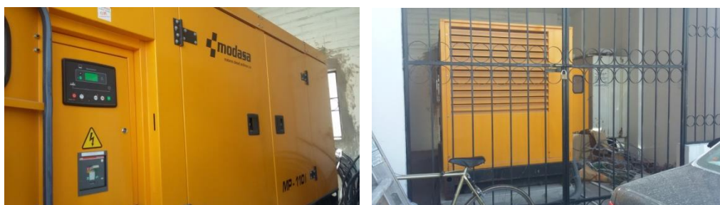
Figura 27 Planta Generadora del GADMO Fuente: Instalaciones GADMO
