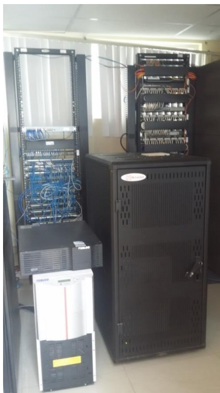
Figura 40 Armarios y bastidores de comunicaciones del CPD. Fuente: Instalaciones GADMO
