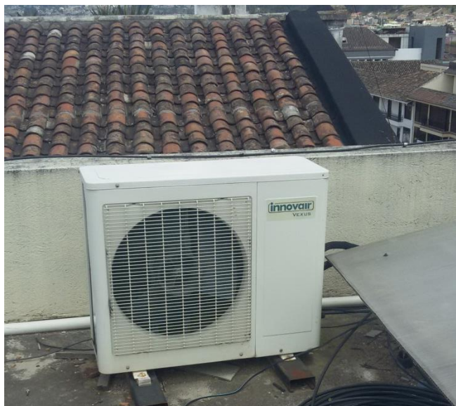
Figura 29 Condensadora del cuarto de equipos de la terraza marca INNOVAIR-VEXUS
