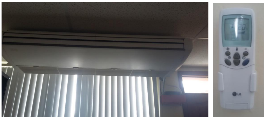
Figura 30 acondicionado del cuarto de equipos de la terraza marca LG
