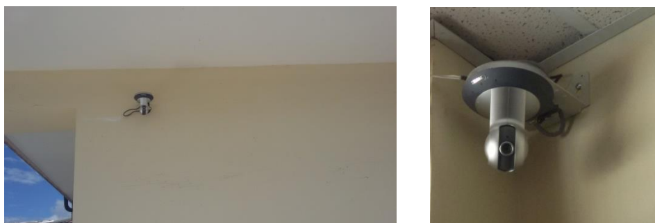
Figura 39 Cámaras de vigilancia del CPD.
