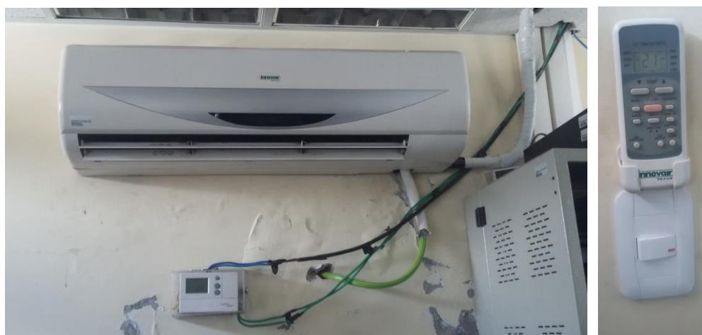
Figura 28 Aire acondicionado del cuarto de equipos de la terraza marca INNOVAIR-VEXUS
