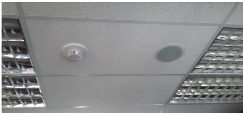
Figura 36 Detector de humo del CPD. Fuente: Instalaciones GADMO
