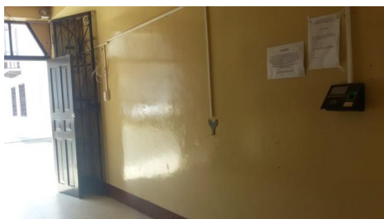
Figura 34 Ubicación del reloj biométrico Fuente: Instalaciones GADMO
