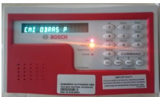
Figura 37 Panel de control de la alarma de incendios del CPD. Fuente: Instalaciones GADMO
