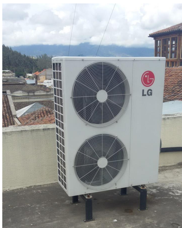
Figura 31 Condensadora del cuarto de equipos de la terraza marca LG
