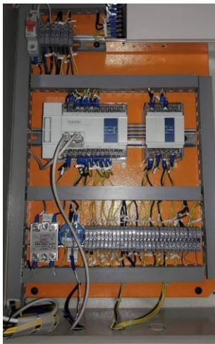
Fig 14 Panel interno del tablero de control
