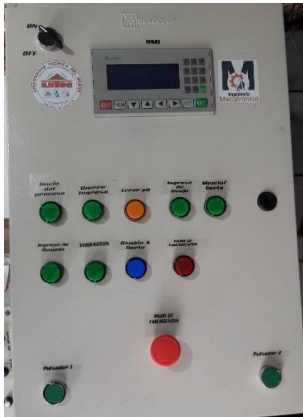
Fig 7 Panel frontal del tablero de control
