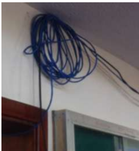
FIGURA 24: Aulas pedagógicas con mala instalación
