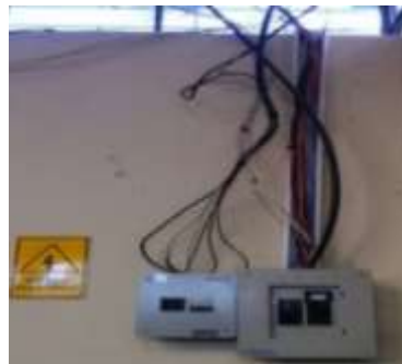
FIGURA 17: Caja de distribución eléctrica, contiene una mala instalación
