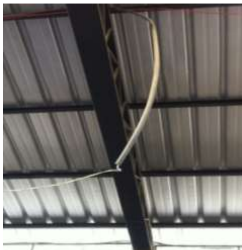
FIGURA 21: Cables eléctricos que sobresalen del techo del taller y que no tiene conexión
