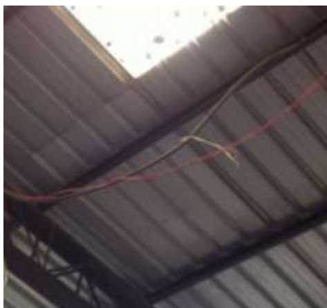
FIGURA 22: Lámparas que se encuentran con instalación inadecuada
