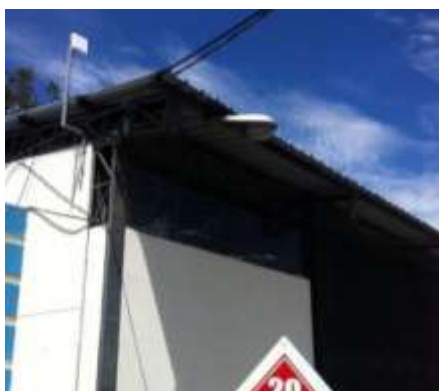
FIGURA 27: Aglomeración de cables cerca de la acometida eléctrica principal
