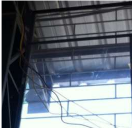
FIGURA 20: Tendido eléctrico sin protección y con mala instalación
