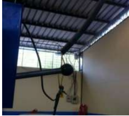
FIGURA 18: Instalación eléctrica inadecuada del elevador
