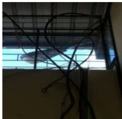
FIGURA 19: Tendido eléctrico inadecuado de 110 y de 220 v
