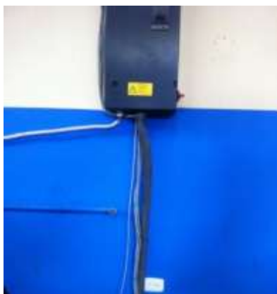
FIGURA 26: Instalación inadecuada del frenómetro
