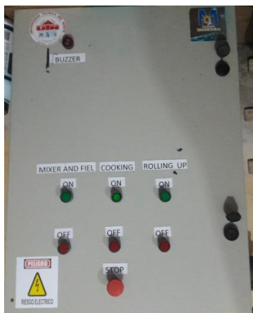
Figura 47: Ubicacion de los dispositivos externos del tablero de control
