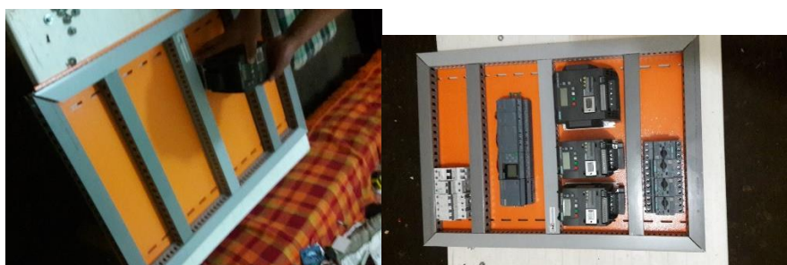
Figura 48: Ubicación de rieles, dispositivos internos y canletas
