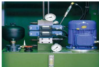
Fig. 28 Instalación Hidráulica para el sistema de presión Rebreker
