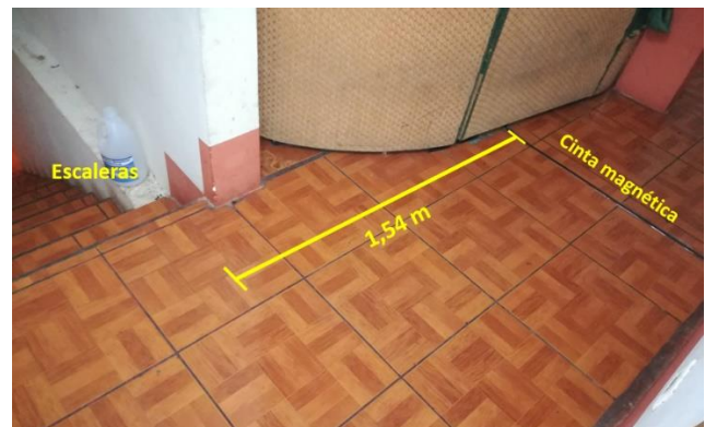
Fig. 24. Cinta magnética instalada a 1,54m de las escaleras
