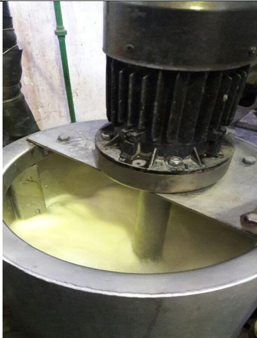
Imagen 40: Batido Tanque auxiliar
