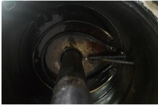
Figura 21. Estado actual de la parte eléctrica (resistencias, termocupla)
