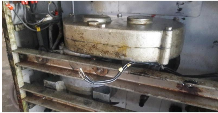
Figura 25. Conexiones del motor antes de la reconstrucción
