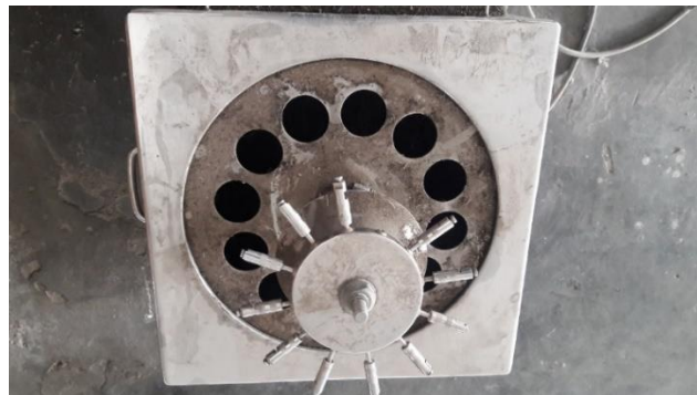
Figura 40. Estado de la parte mecánica (soporte de tubos) antes de la reconstrucción
