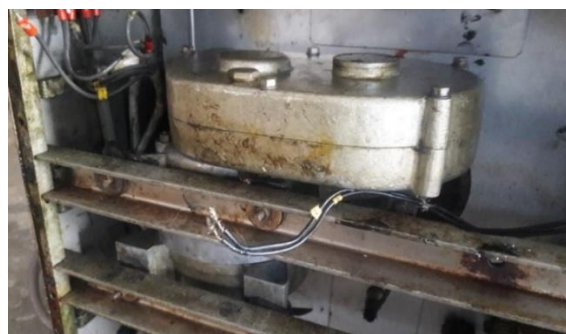
Figura 20. Estado actual de la parte eléctrica (motor)
