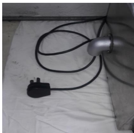
Figura 35. Adaptación de un enchufe trifásico
