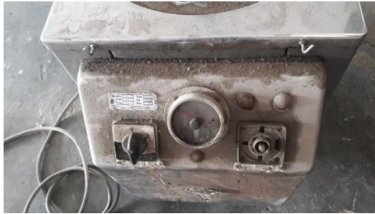
Figura 38. Estado de la parte mecánica (panel frontal) antes de la reconstrucción
