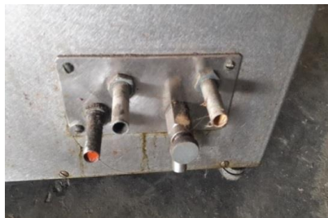
Figura 58. Entradas y salidas de agua-glicerina antes de la reconstrucción.
