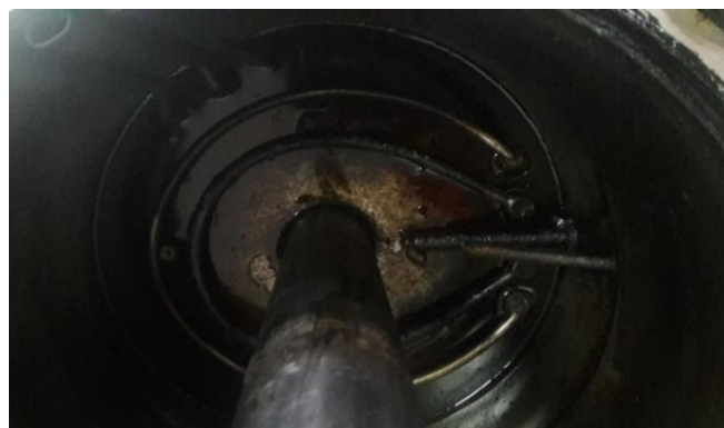
Figura 31. Resistencias eléctricas antes del mantenimiento
