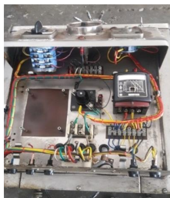
Figura 26. Sistema eléctrico (gabinete) antes de la reconstrucción
