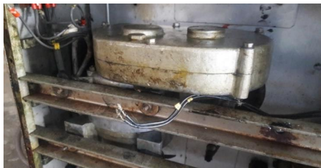
Figura 41. Motor antes de la reconstrucción.
