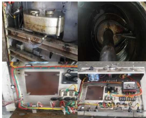
Figura 1: Estado inicial de parte eléctrica (izquierda), estado actual (derecha) del equipo.
