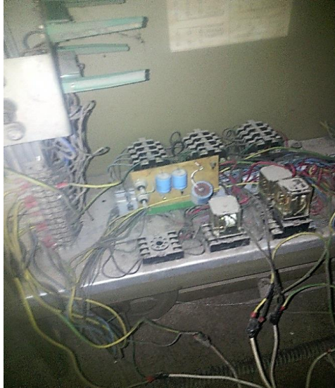
Figura 37 Caja de tablero eléctrico
