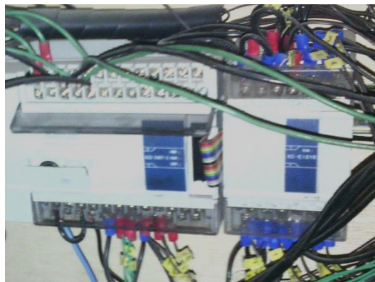
Figura 49 Instalación del PLC en la maquina
