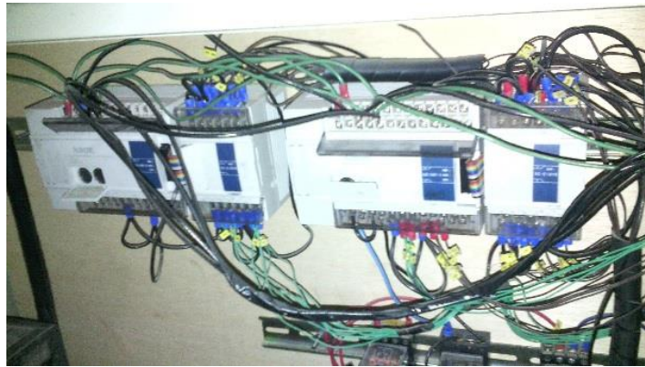
Figura 51 PLC montaje final dentro de la caja para control automático
