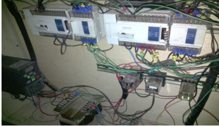
Figura 16 Representación del montaje eléctrico de PLC, conminación con las levas de trabajo y guía hilo.
