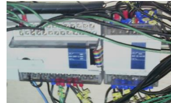
Figura 14 Instalación del PLC en la maquina
