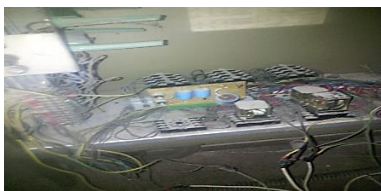
Figura 3 Caja de tablero eléctrico
