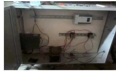
Figura 13 Montaje PLC en la caja de control de mando
