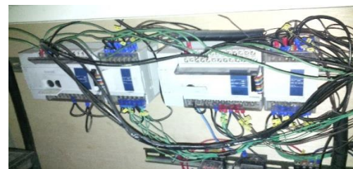
Figura 15 PLC montaje final dentro de la caja para control automático
