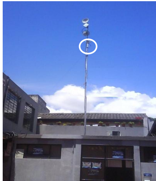
b) Radio Instalado en EMELNORTE
