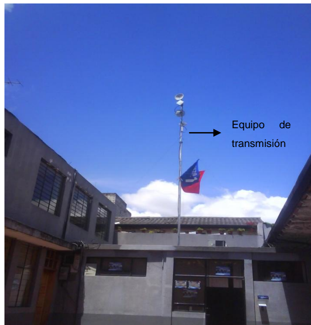
Figura 39. Mástil de comunicaciones instalado en EMELNORTE
