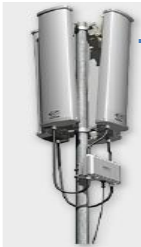
Figura 34. Radio con 4 salidas RF independientes, con antenas sectoriales
