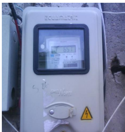
Figura 41. Registrador Electrónico Monofásico Instalado en San Antonio de Ibarra
