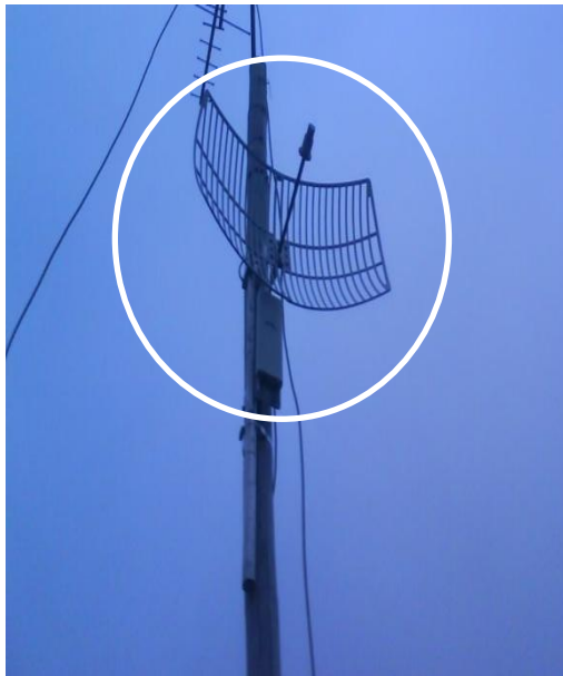
a) Radio y antena Instalado en San Antonio
