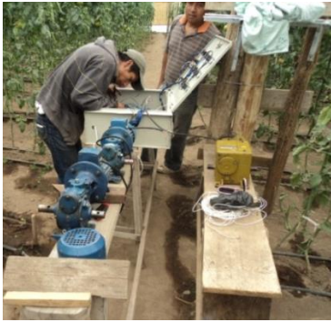
Figura 17 Comprobación de del sistema de control sin carga.
