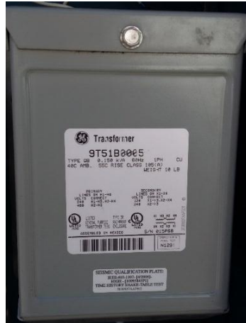
Figura 9 Transformador de aislamiento
